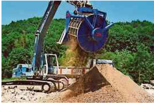
1998 das erste Trommelsieb bei Fa. Alder in Betrieb, heute überall alltäglich
